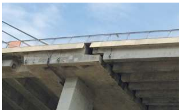
Une photo de la fissure dans le pont Phu My le 2 août 2015
